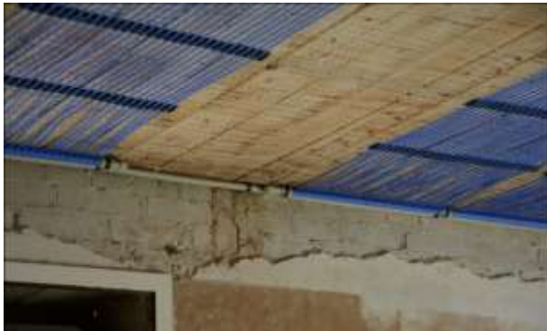
Bild 4: Kapillarrohrmatten mit Haltebänder angeschraubt
